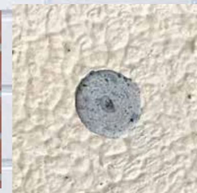
塗膜剥離状態
